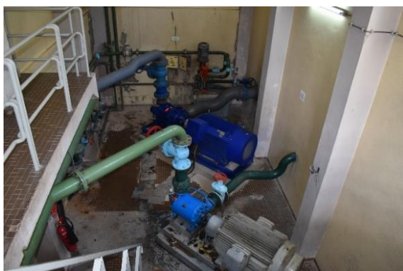
Figura 11: Disposição das bombas na ETA / EET1
